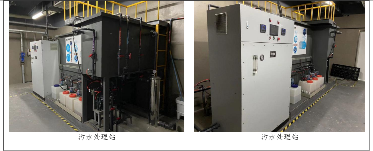
图 3-4 租赁方污水处理站现场图
